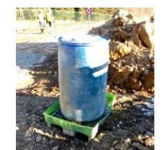
Stockage d'hydrocarbures dans un bidon étanche sur un bac de rétention
